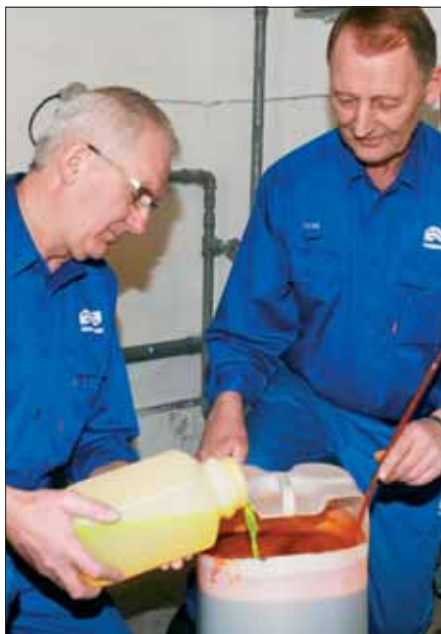
Ledningsmester Karsten Christensen og reparatør Evan Hougaard tilsætter fjernvarmevandet grønt farvestof.
